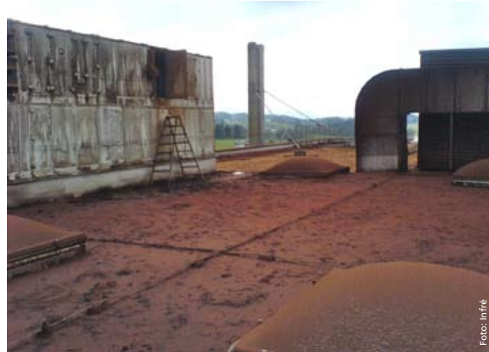
Vor Inbetriebnahme der neuen Staubfilteranlage: Zentimeterdick liegt der Teestaub auf dem Fabrikdach.
