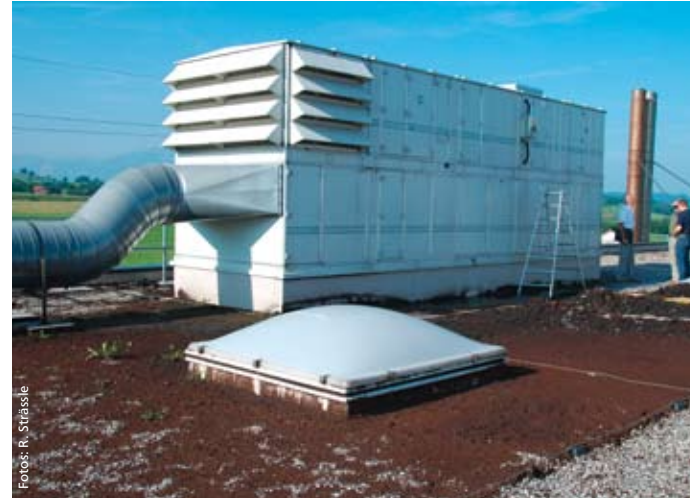
Noch ist das Kiesdach nicht gereinigt, doch die neue Filteranlage zeigt Wirkung – der Teestaub kommt nicht mehr durch.
