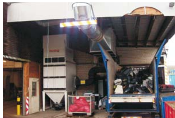
Filteranlage mit Wärmetauscher und Frischluftansaugung bei ELPRO
