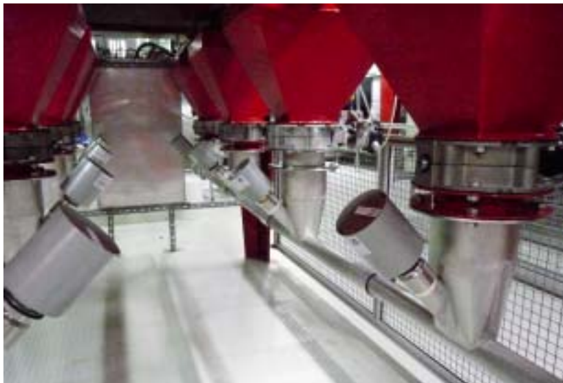
Unter den Filtern wurde eine pneumatische Förderung zu einem zentralen Filterabscheider installiert
