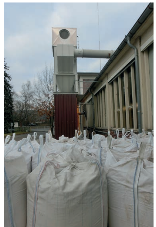
Bild 5 Herding Entstaubungsanlage mit Reinlufrückführung – Herstellprozess Technische Keramik
